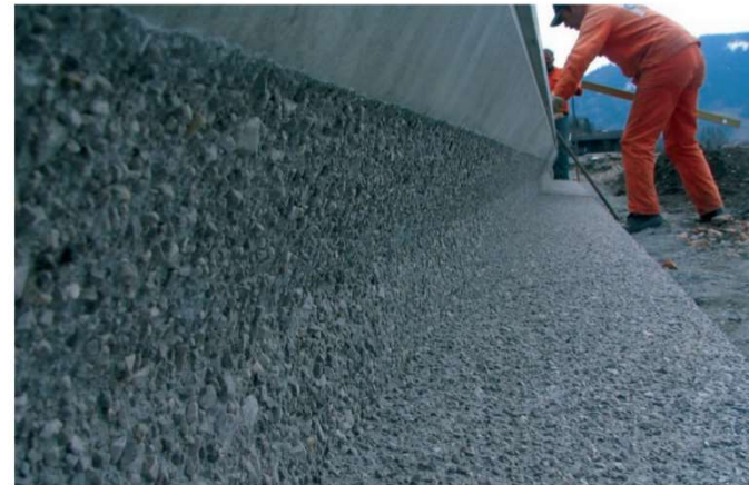
Abb. 4: Leitelement aus der "Froschperspektive" - Lauffläche und Leitwand sind aus Waschbeton, der Überhang ist mit einem zusätzlichen Überstiegsschutz versehen (Foto: M. KYEK)
